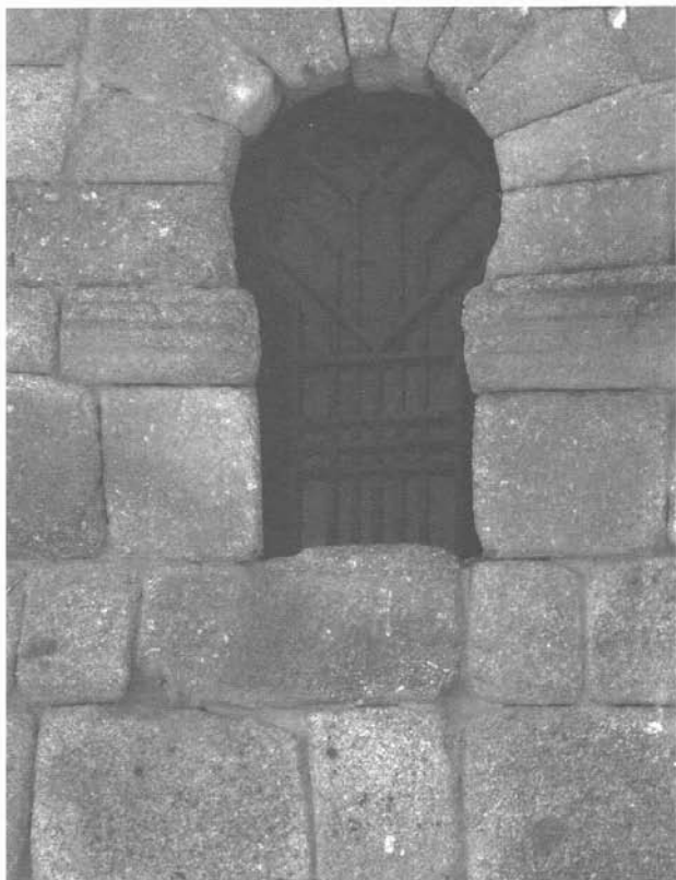
Fotografía VIII.- Detalle del cerramiento actual de las ventanas del edificio. Previsiblemente esta necesidad nació vinculada a la seguridad actual contra posibles robos, cambiando el diseño por el afán creador de los segundos arquitectos restauradores, cuyo gusto estético se impuso sobre el de Menéndez Pidal.
