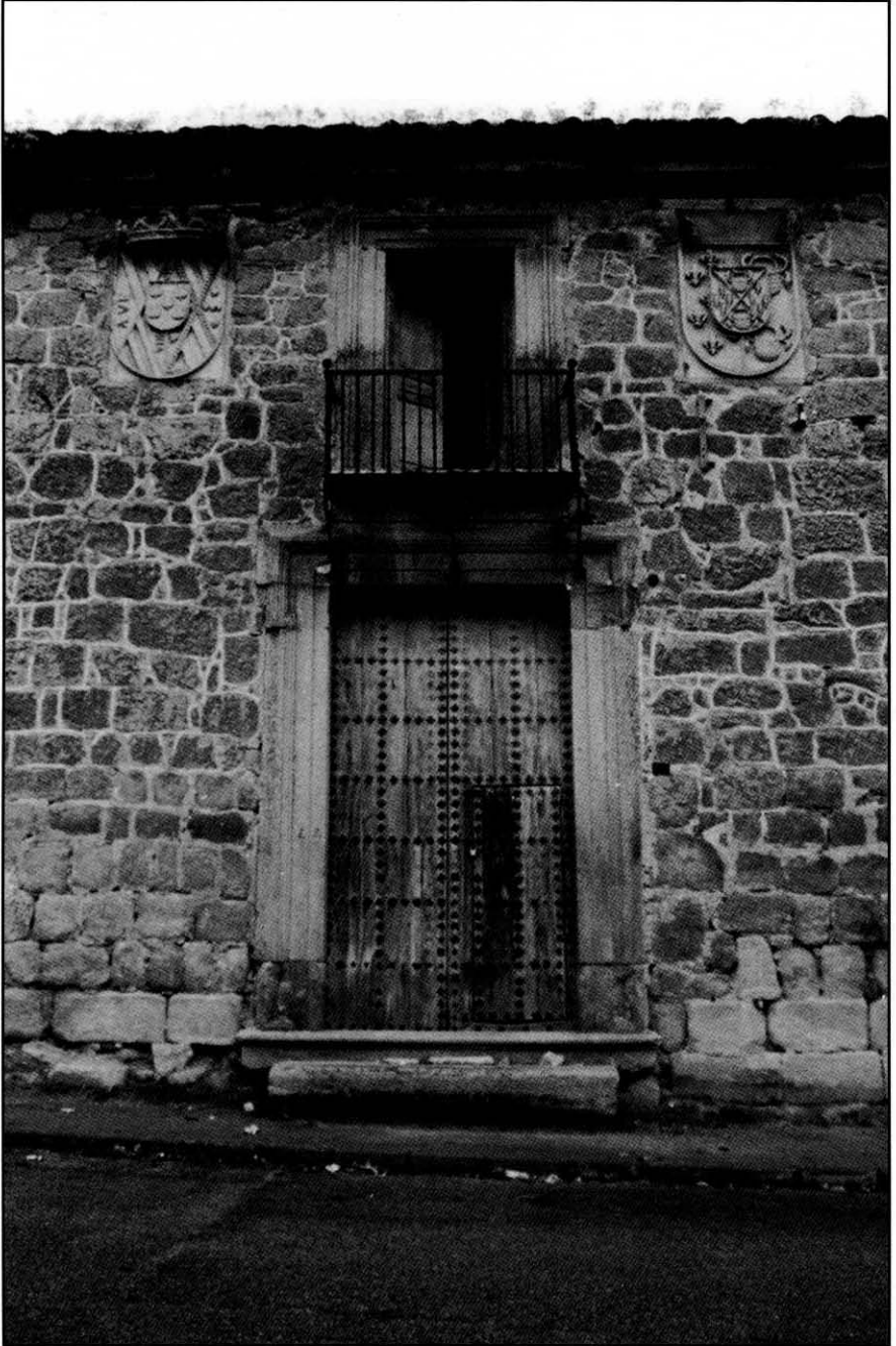
Lámina 4.-Detalle de la portada, antes de su restauración.
