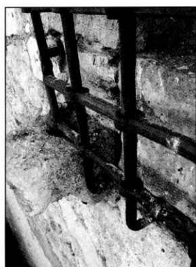
Fig. 63: Ménsula izquierda de la reja a en la fachada norte.
