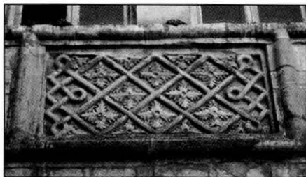
Fig. 57: Panel de tracería con entrelazo geométrico en el Lado c del patio.
