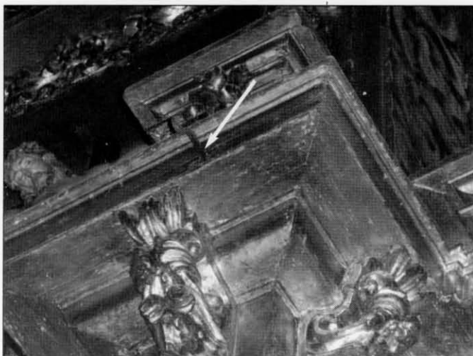
Anclaje para paños de Cuaresma y Semana Santa. Se aprecian leves desencajes causados por el terremoto de 1755.
