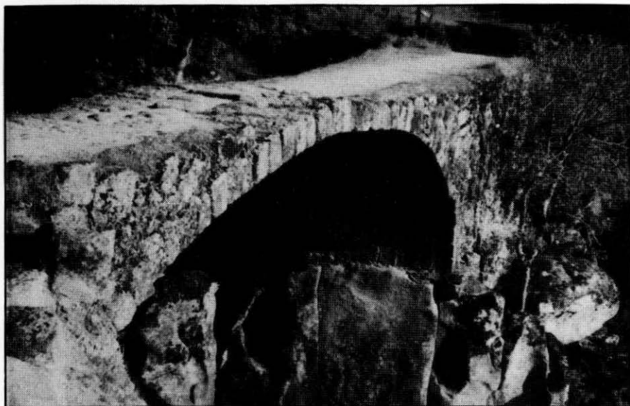
Puente sobre el Guadyerbas, que ha perdido el pretil.
